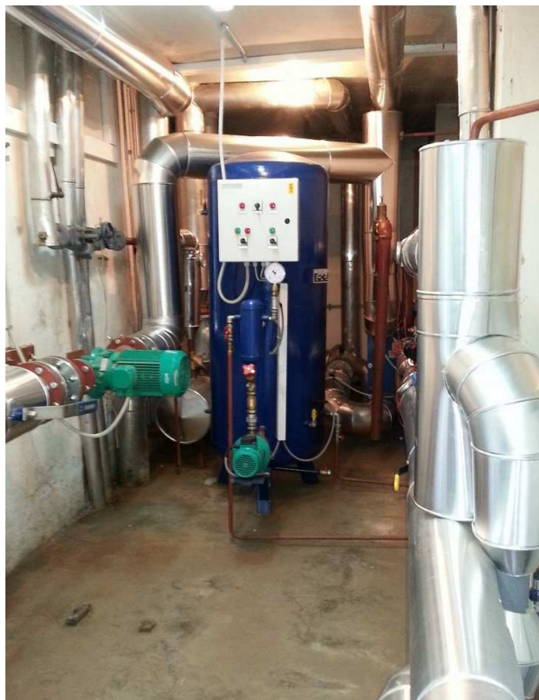
Sl. 2. Primarni deo toplotno-predajne stanice
